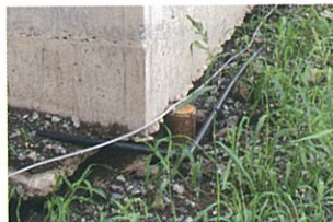
基礎周りの浮きとズレ
