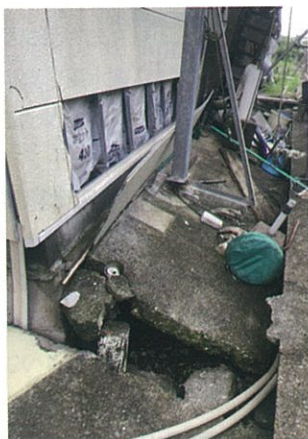
基礎周りの浮き
