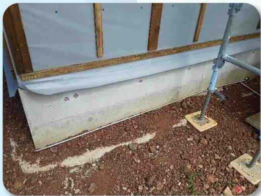
根入れ深さ不足（ベタ基礎）
